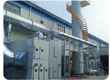
广东惠州钢结构喷漆废气治理项目
