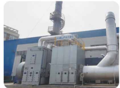
河南郑州包装厂印刷废气治理项目
