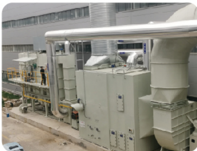
山东小蚂蚁汽车涂装废气治理项目
