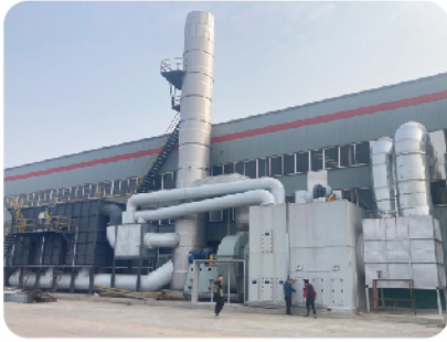
河南巩义铝业喷漆废气治理项目
