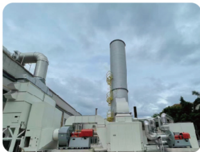
广东人造石公司苯乙烯废气治理项目
