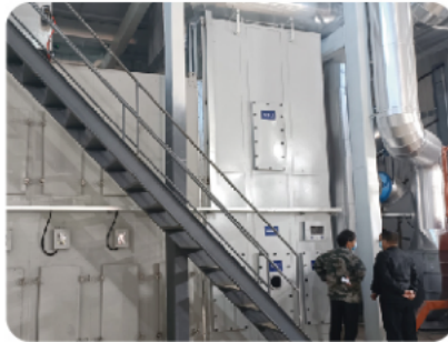
无锡游艇厂苯乙烯废气治理项目
