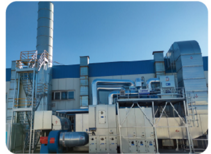
北京家具厂喷漆废气治理项目
