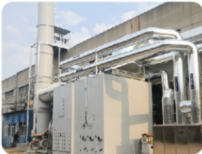
山东济南改装车辆厂喷漆废气治理项目
